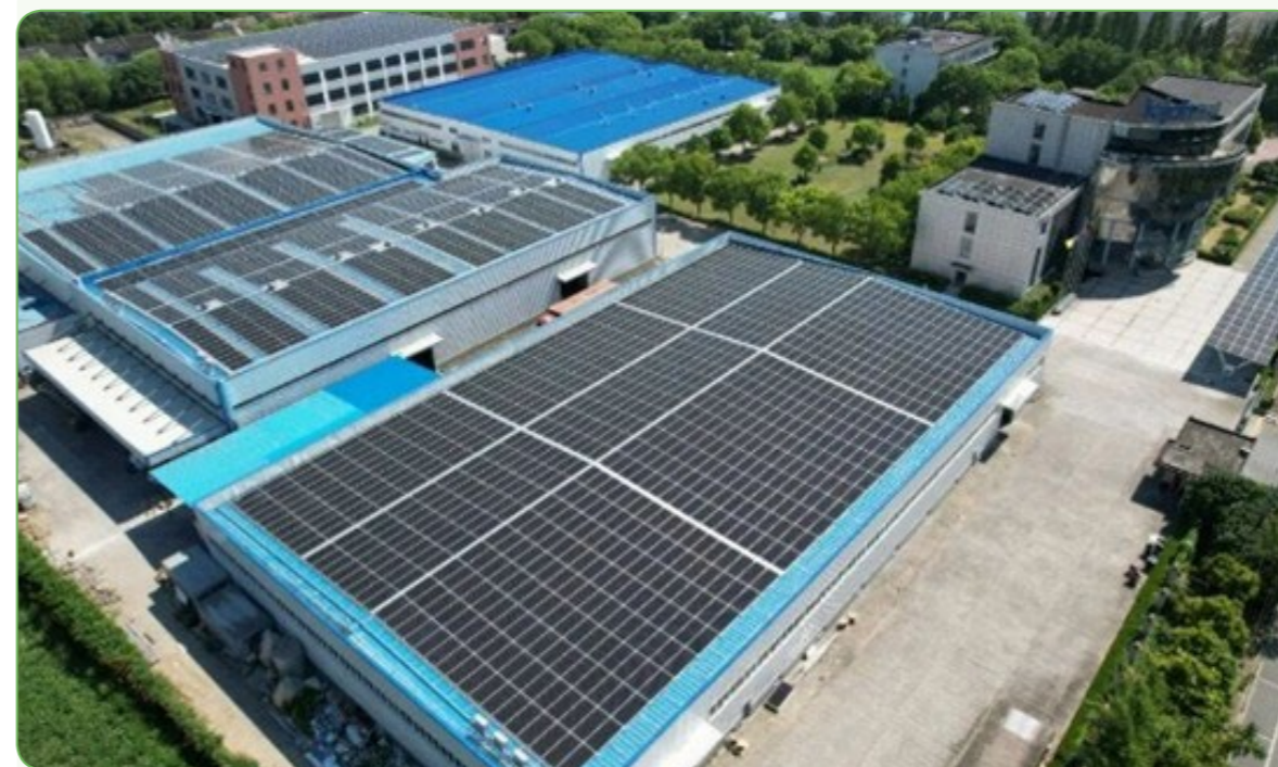
建发汽车二期 2.2MW 分布式光伏项目
